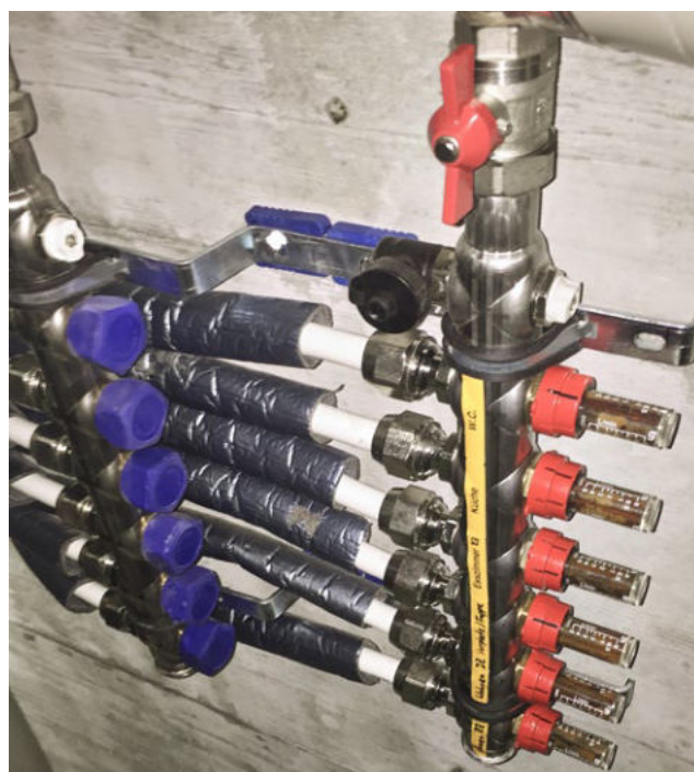
[ABB. 3] Verschmutzte Durchflussanzeiger nach zwei Betriebsjahren.
