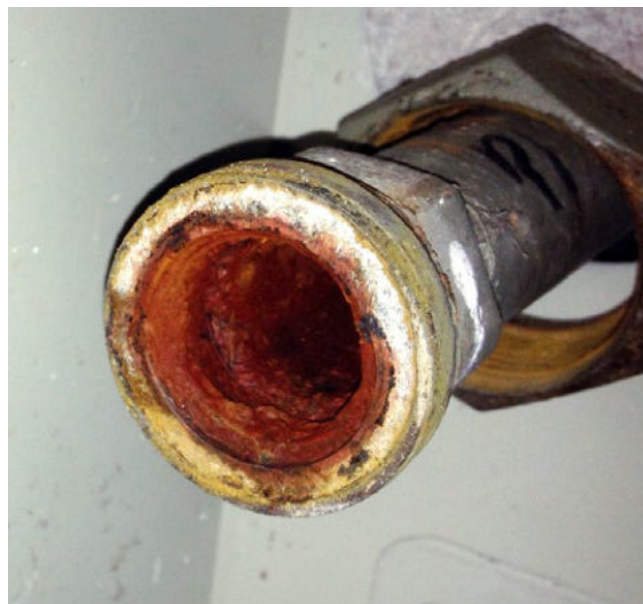
[ABB. 2] Fussbodenheizungsverteiler: Korrosionsrückstände.
